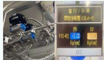
PLC 控制，壓力過高自動排氣及防範真空及排氣閥同開。
