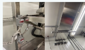
桶槽定位機制，未達密閉定位，設備無法攪拌做動，降低有機物噴濺洩漏及捲夾風險
