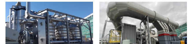
沸石吸附 + 觸媒式焚化爐 (CTO) 沸石轉輪 + 蓄熱式焚化爐 (RTO)
